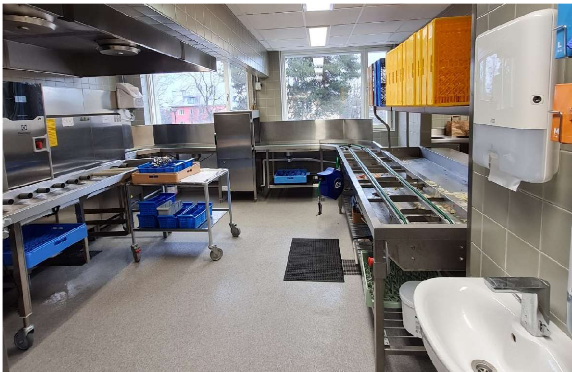
Bild: Det nyrenoverade serveringsköket vid Ålands lyceum. Foto: Elisabeth Rosenlöf, Fastighetsverket
